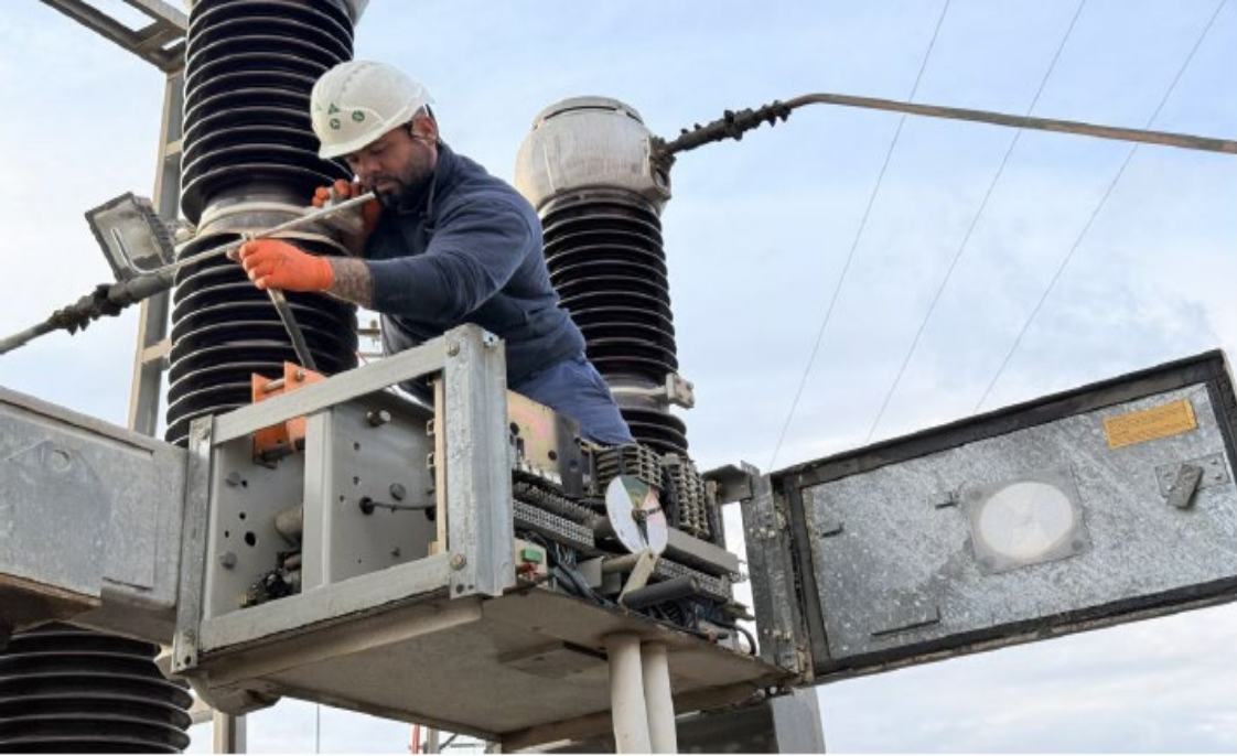
Rotura de las subestaciones
