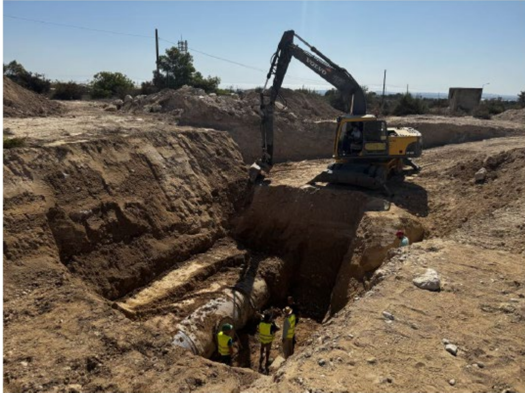
1. Imagen de la rotura de la bajante derecha donde se aprecia la profundidad ( > 8\text{m} ) a la que están las conducciones
