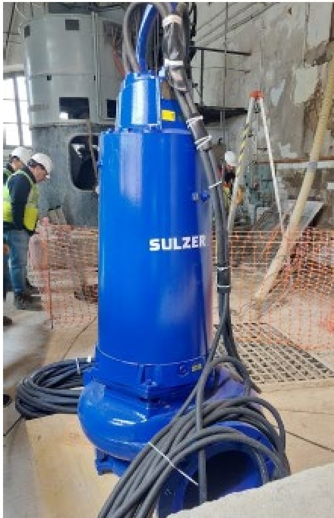
Nueva bomba en 1ª Elevación ( Q=300 l/s)
