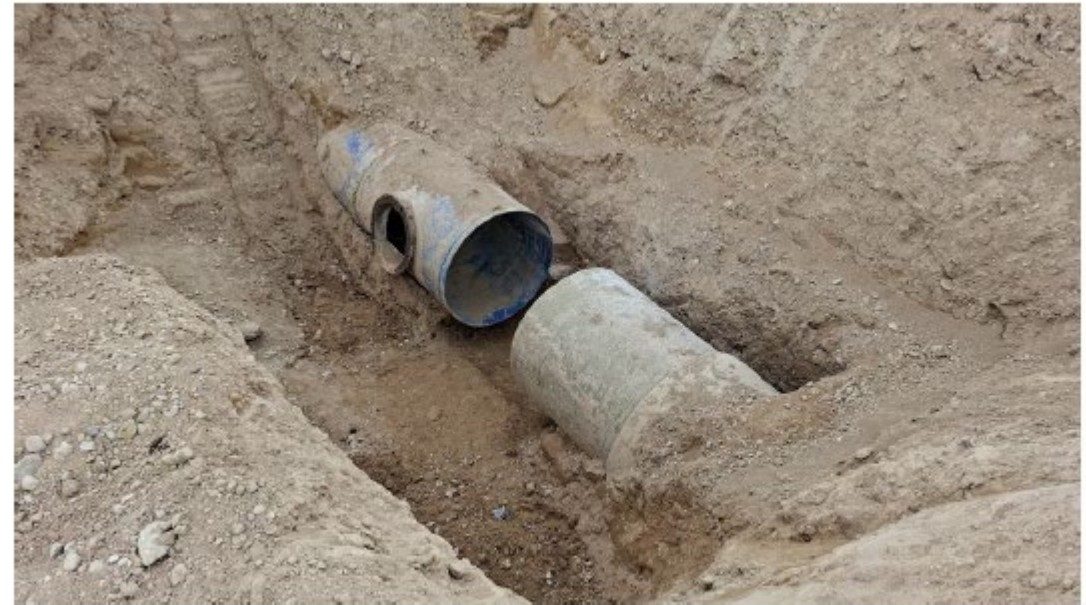
2. Tubo de la bajante derecha cortado a la espera de ser reparado. El carrete metálico (azul) es de una rotura anterior
